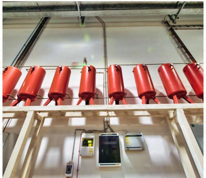
Pneumatikus vezérlés - Schaeffler Debrecen
